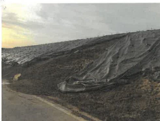
De la terre a encore récemment coulée au droit d'un drain existant...
