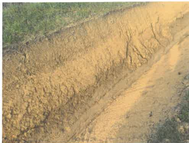
Preuve que le fossé assure sa fonction, les traces au niveau du fil d'eau
