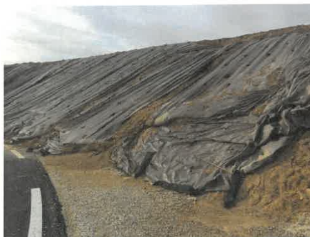
Le talus est totalement déstructuré. De surcroit, une dépose/repose de la bâche est obligatoire ainsi que la reposes de nouvelles plantations
